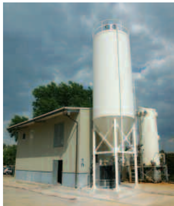
Depuradora d'aigües industrials
